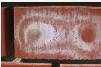
Ausblühungen an einer Fassade aus saugfähigen Vormauerziegeln, verursacht durch Reinigung mit Salzsäure.
