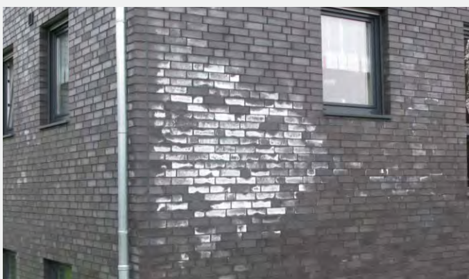
Vorübergehende Ausblühungen bei einer neu errichteten Ziegelfassade als Folge einer permanenten Durchfeuchtung des Mauerwerks während der Bauphase.
