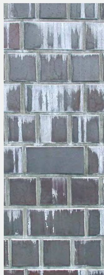
Kalkauslaugungen als Folge mangelhafter nachträglicher Verfugung.
