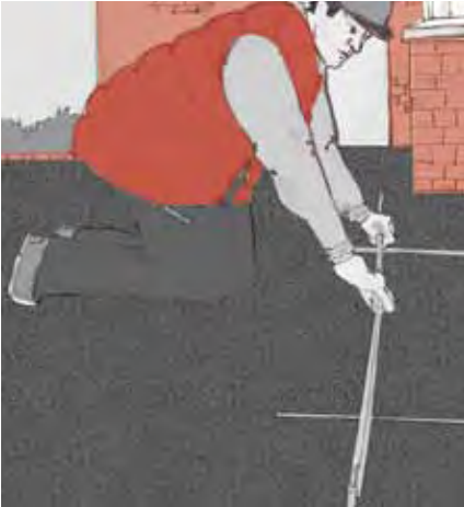
17. Das Abziehen der Bettung kann nun erfolgen. Hierfür werden die Abziehlehren in der vorgesehenen Höhe und dem entsprechenden Gefälle eingemessen.
